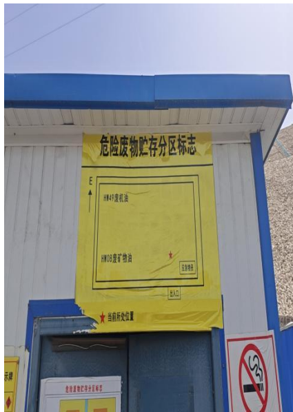
危废暂存库分区标志
