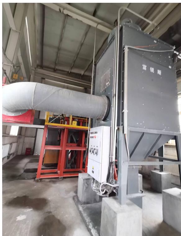
投放站的喷雾设施及烧结板除尘器
