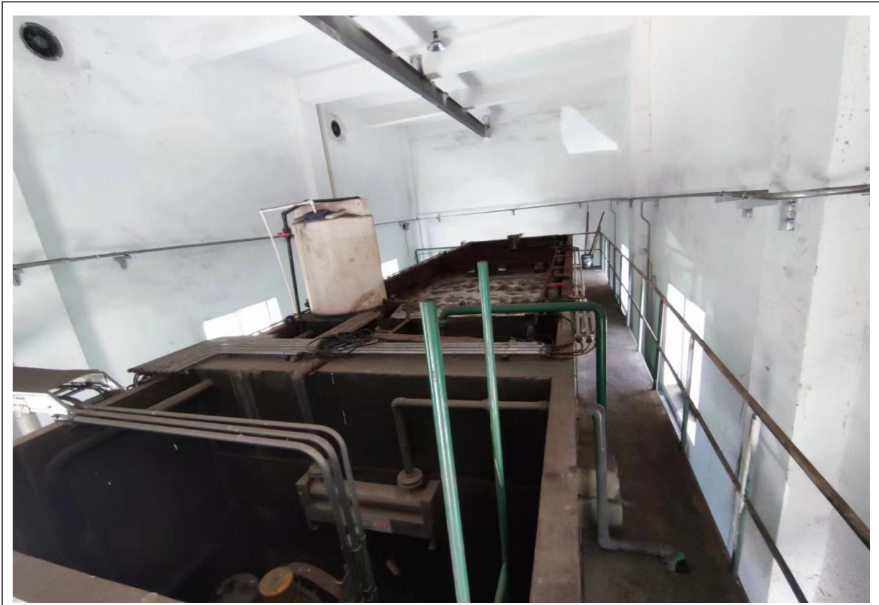
生活污水处理设施
