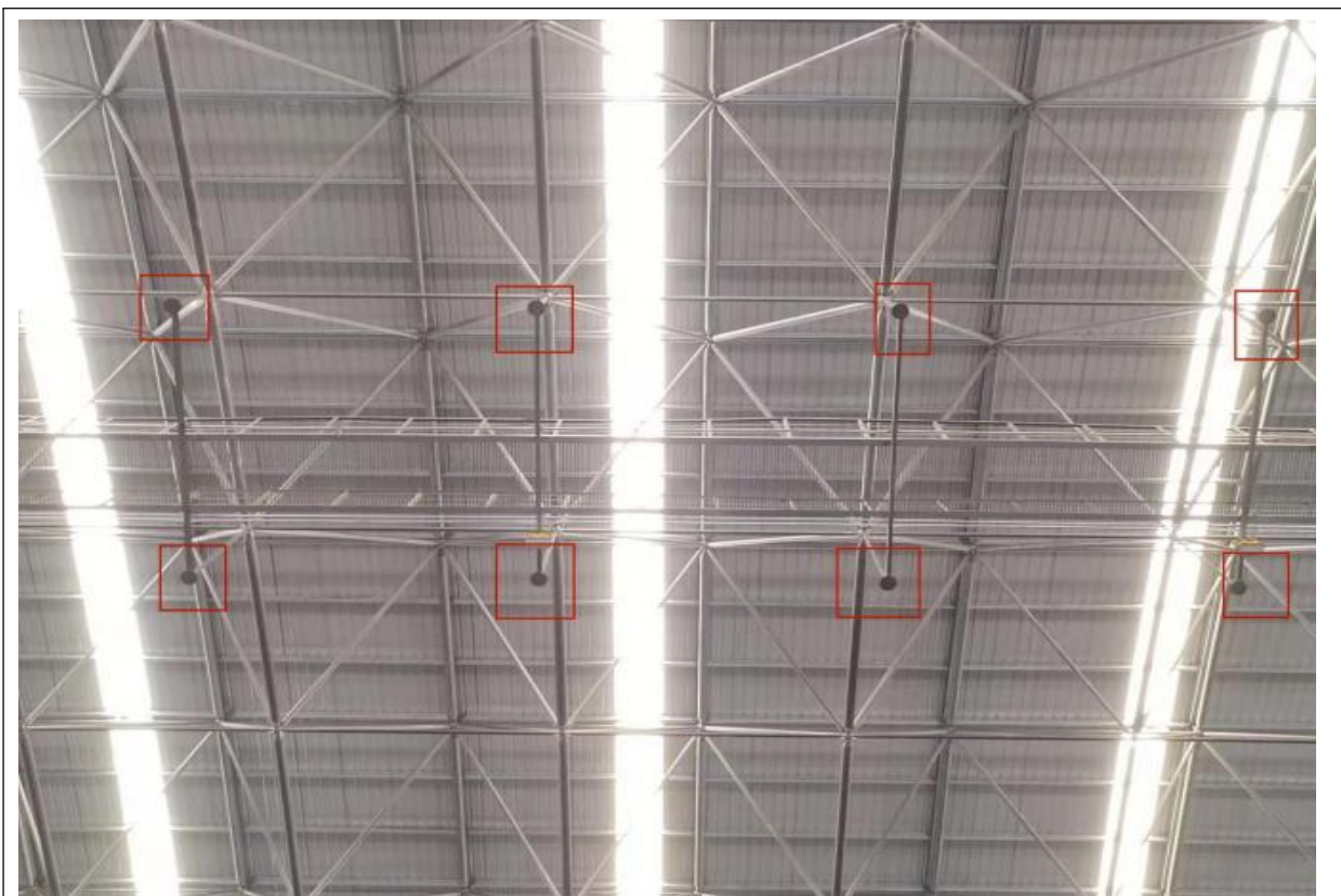
洒水抑尘装置
