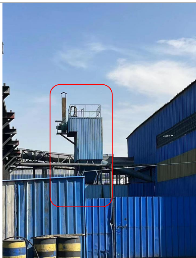
兰炭受料坑除尘器
