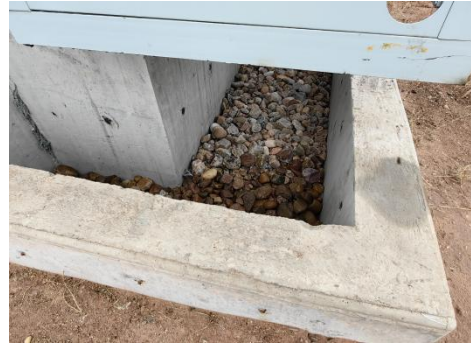
箱式变电站事故油池
